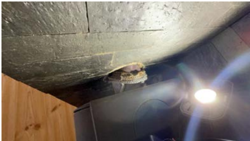
Synlig sot og løst tau rundt rørgjennomføring.
