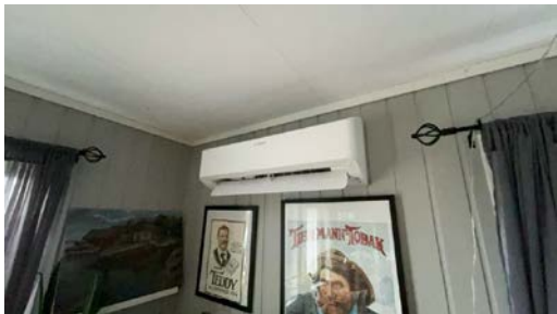
Varmepumpe, innvendig komponent.
