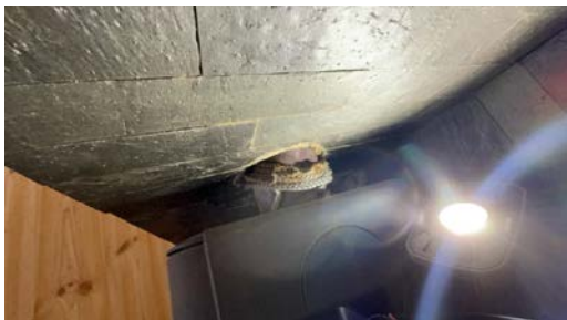
Synlig sot og løst tau rundt rørgjennomføring.
