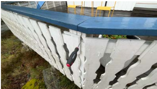
Stedvis råde i terrassekonstruksjon.
