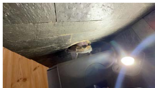
Synlig sot og løst tau rundt rørgjennomføring.
