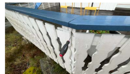
Stedvis råde i terrassekonstruksjon.
