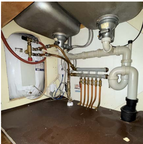
Bereder og stoppekran i kjøkkenskap.
