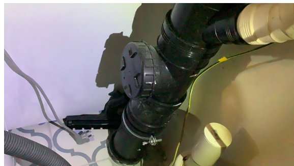
Nyere plastrør på deler av anlegget.
