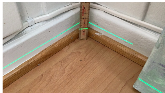
Soverom 2. etasje har 15 mm høydeforskjell.
