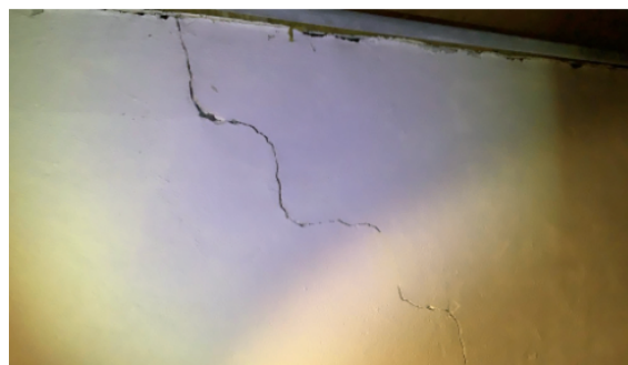
Det er sprekk i mur mot vest. Denne er fulgt med på over tid, og virker stabil.
