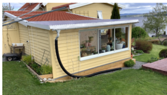
Hagestue mot sør ved garasje. takplater er ikke godkjent lagt med så lite fall på tak. Vedlikehold må påregnes.
