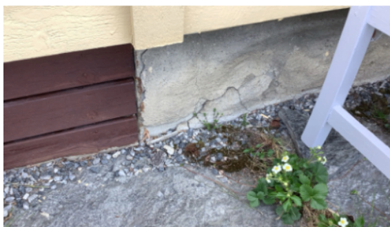
Det er sprekker i murpuss utvendig mur
