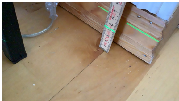
Stue 1. etasje har 5 mm høydeforskjell.
