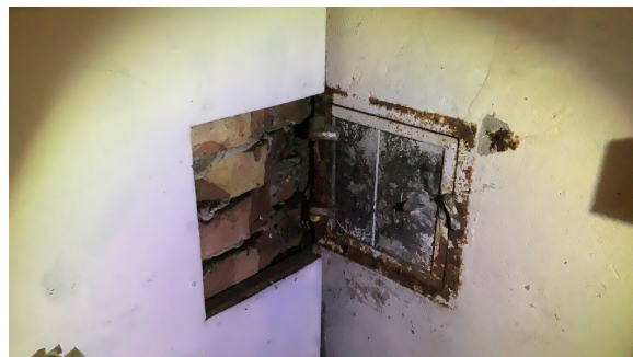
Det er brennbar materiale nærmere enn 30 cm fra sotluke, dette må fjernes.
