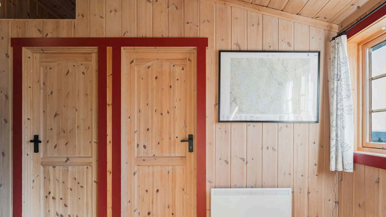
Elektrisk oppvarming med panelovner, samt gulvvarme i entré og på badetom. Det er ring hytta varm-løsning.
