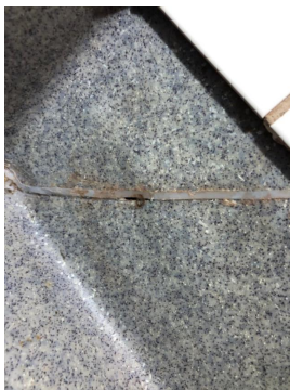
Bilde av glippe/sprekk i gulvbelegget
