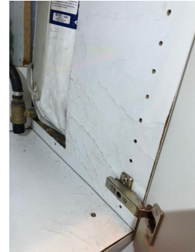
Bilde av svelling/skade på kjøkkenskrog
