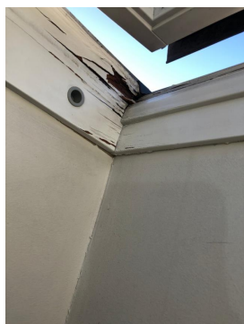
Bilde av råteskader på takvindu
