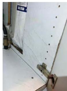
Bilde av svelling/skade på kjøkkenskrog
