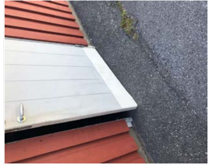
Dør som subber mot terreng
