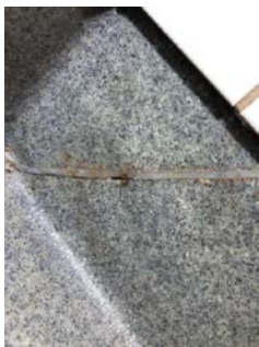
Bilde av glippe/sprekk i gulvbelegget
