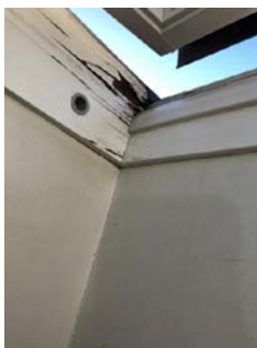
Bilde av råteskader på takvindu
