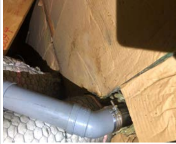
Fuktskjolder på isolasjon. Antatt fra kondens
