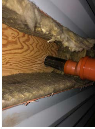
Bilde av manglende isolasjon rundt avløprør i krypkjeller
