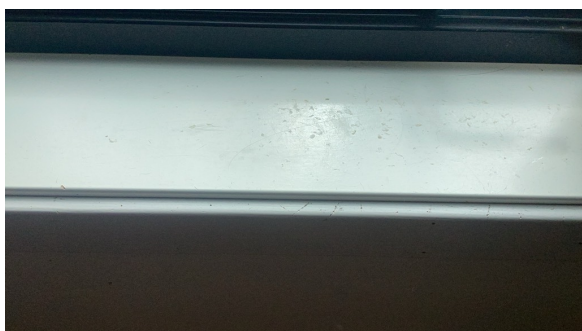
Enkelte småsår i vinduskarm.
