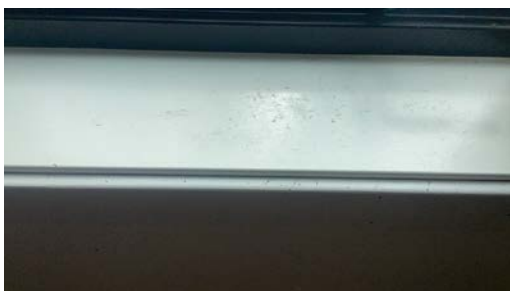
Enkelte småsår i vinduskarm.
