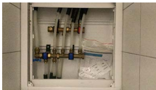
Fordelerskap på bad.
