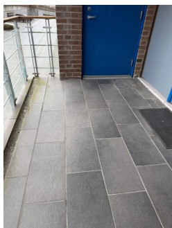
Balkong i betong ved inngang belagt med fliser.
