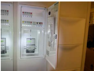
Sikringsskap står i entre/gang.
