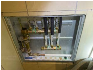
Rør i rør skap står i bad/vaskerom
