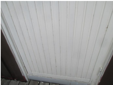
Slitt balkongdør på loftet.
