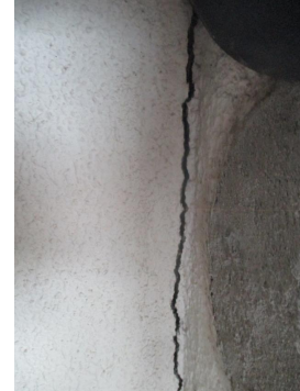
Sprekk i mellom brannmur og pipe i stue.
