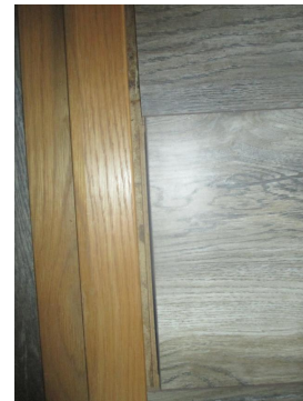
Overgangslister mangler flere plasser.
