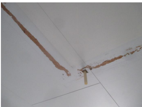
Merker i himling på soverom på loftet.
