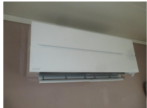
Varmepumpe i stue.
