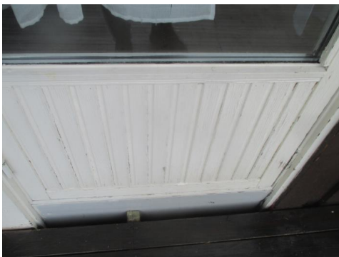
Slitt balkongdør i stue.
