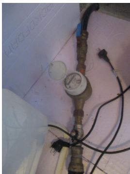
Innvendig stoppekran med vannmåler.
