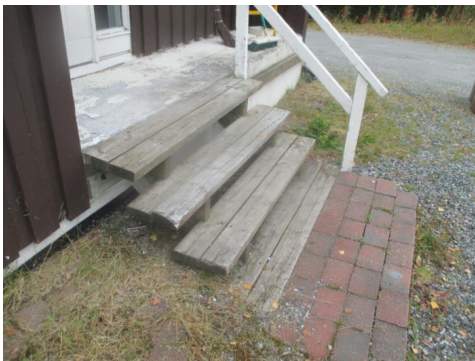
Enkel slitt trapp ved inngangsparti.
