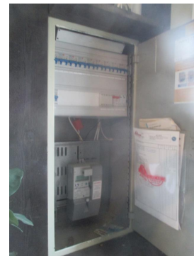
Sikringsskapet er plassert i vindfang.-
