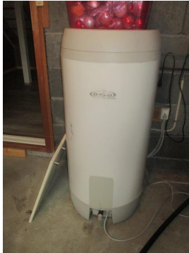
Bereder er plassert på vaskerommet.
