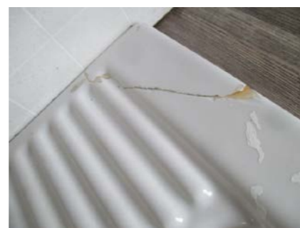
Sprekk/skade på vaskekum.
