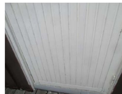
Slitt balkongdør på loftet.
