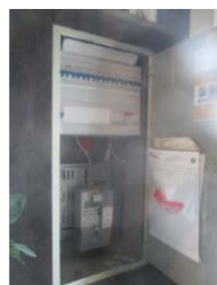
Sikringskapet er plassert i vindfang.-
