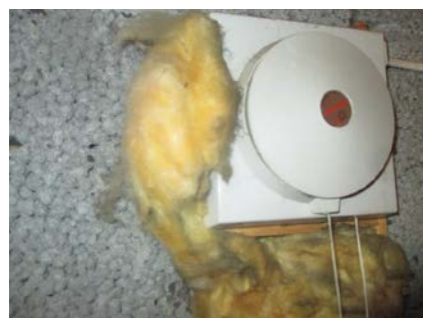
Eldre vifte i grunnmur.
