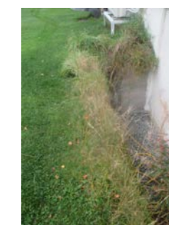
Mangler rekkverk på forstøtningsmur.
