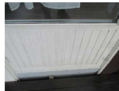
Slitt balkongdør i stue.
