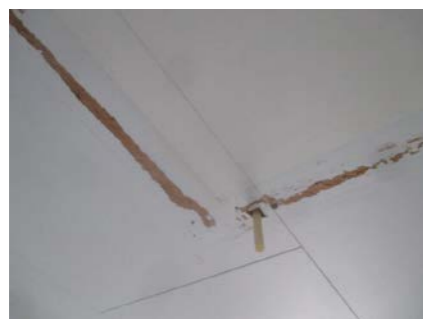
Merker i himling på soverom på loftet.
