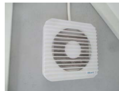
Vifte i ytterveggen.
