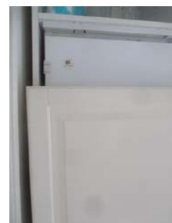
Dører passer ikke til innebygd kjøleskap.
