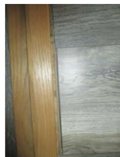
Overgangslister mangler flere plasser.
