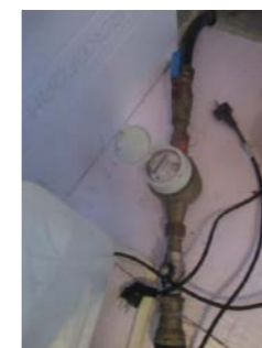
Innvendig stoppekran med vannmåler.
