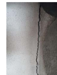
Sprekk i mellom brannmur og pipe i stue.
