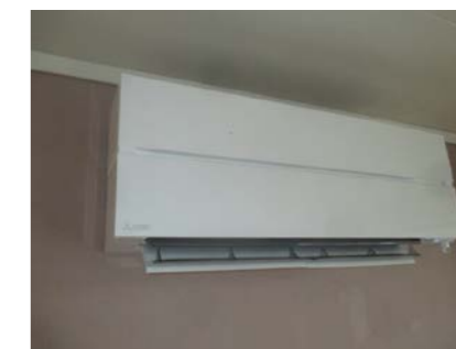
Varmepumpe i stue.
