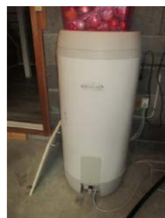
Bereder er plassert på vaskerommet.
