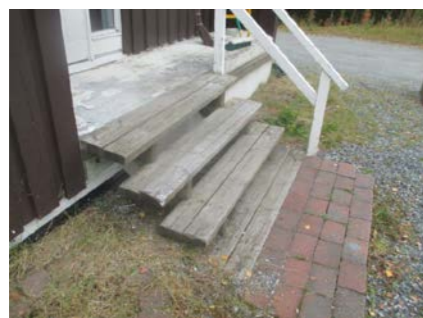
Enkel slitt trapp ved inngangsparti.
