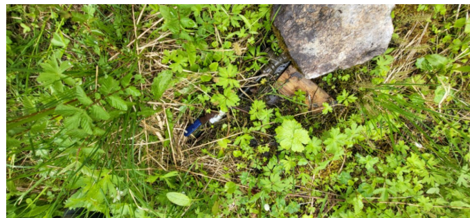
Utendig stoppekrane for vannledning.
