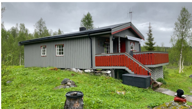
Synlig skjevhet på terrasse
