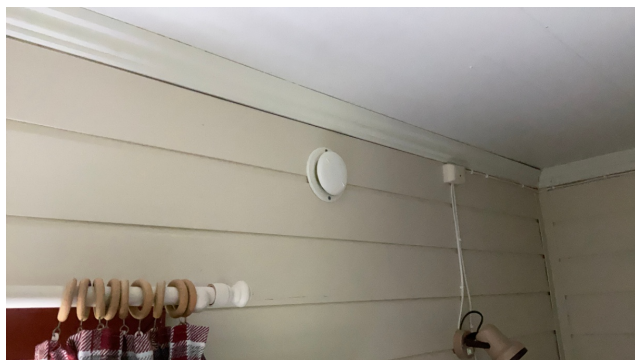
Veggventil på soverom.
