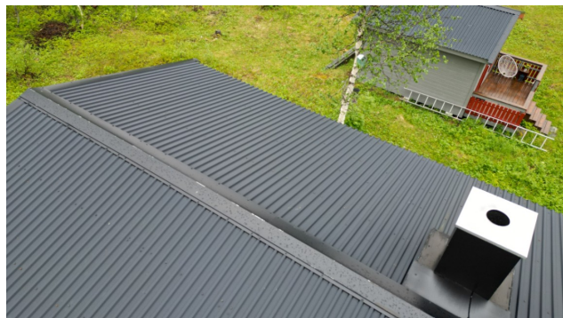
Noe rust på skruer på taket.
