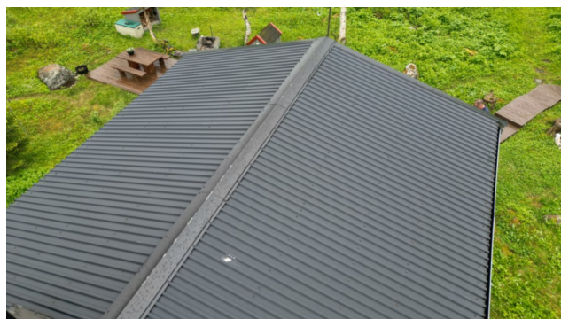
Noe overflateslitasje på mønekam.
