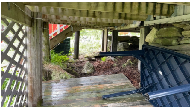
Fundamentering. Skjevheter i pilarer.
