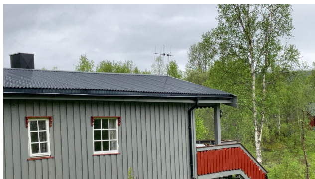
Utvendig takkonstruksjon har synlig nedbøy i takteknet.
