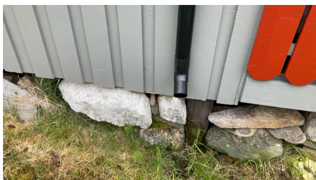
Manglende overvannsrør som leder bort vann fra bygningen.
