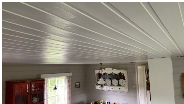
Synlig nedbøying i himling på stue
