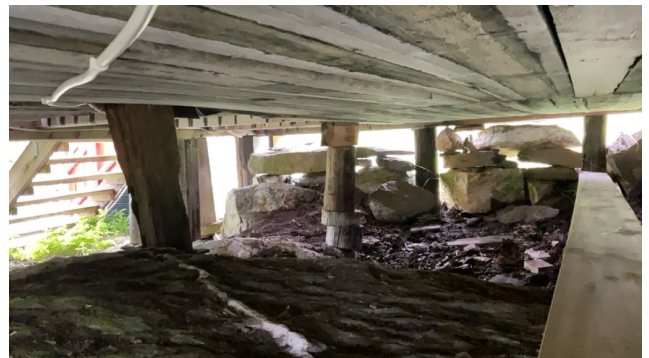
Skjevhet i pilarer
