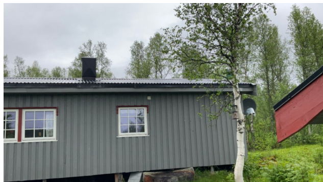
Takrenner mot sør er falt ned.
