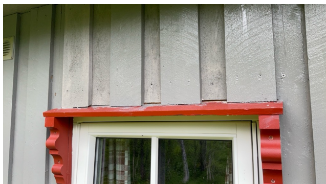
Manglende beslag på vannese over vinduer.
