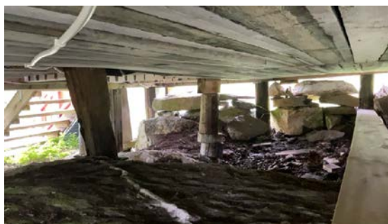
Skjevhet i pilarer
