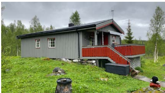
Synlig skjevhet på terrasse
