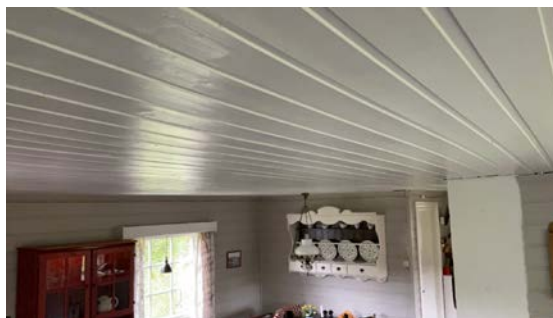
Synlig nedbøyning i himling på stue
