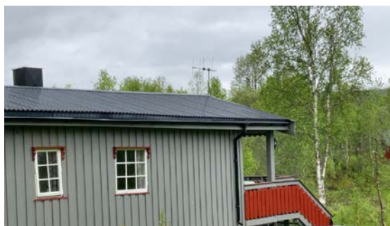
Utvendig takkonstruksjon har synlig nedbøy i taktekket.
