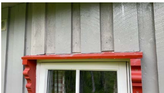
Manglende beslag på vannese over vinduer.
