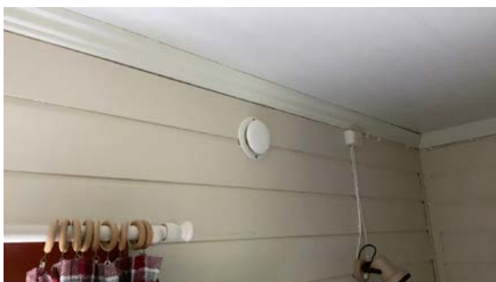
Veggventil på soverom.
