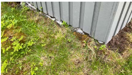
Kledning er for nære bakken.
