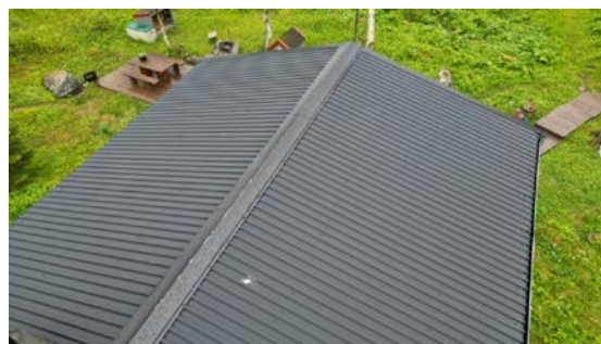
Noe overflateslitasje på mønekam.
