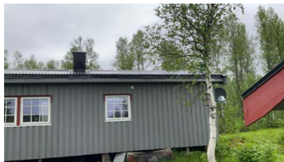
Takrenner mot sør er falt ned.
