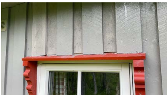
Manglende beslag på vannese over vinduer.
