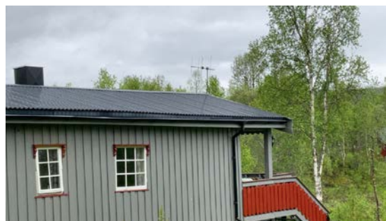
Utvendig takkonstruksjon har synlig nedbøy i taktekket.
