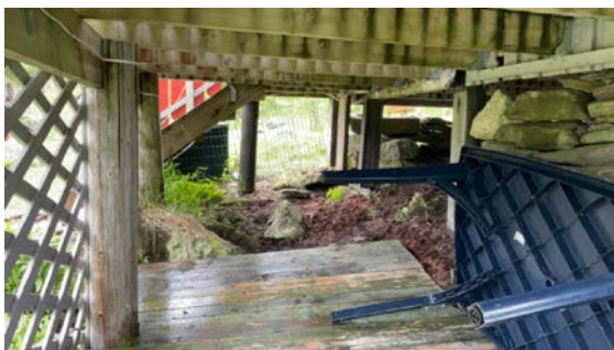
Fundamentering. Skjevheter i pilarer.
