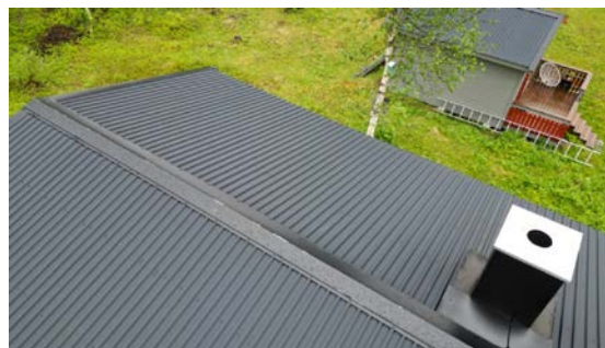
Noe rust på skruer på taket.
