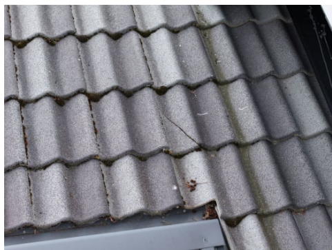
Det registreres en knekt takstein ved takvindu.
