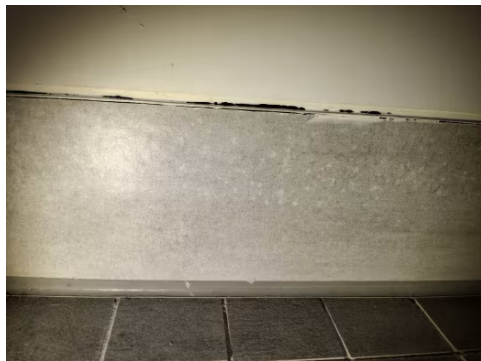
Sprekker i elastisk fuge mellom plater og sokkellist.
