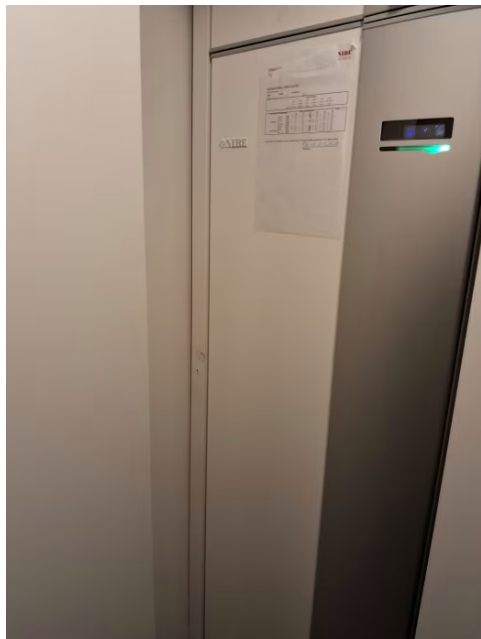
Avtrekksvarmepumpe er plassert i bod/teknisk rom.
