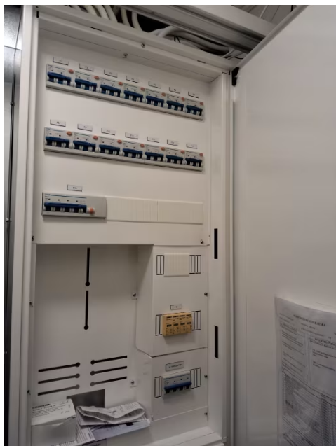
Sikringsskap med automatsikringer plassert i bod/teknisk rom.
