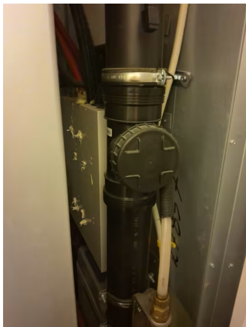
Stakeluke er plassert i bod/teknisk rom.
