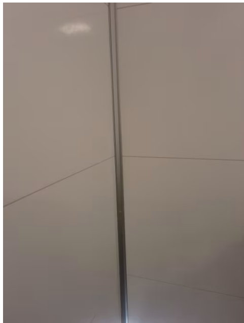
Innerhjørner er ikke tettet med tilstrekkelig fugemasse (plater kan beveges fra klemlist).
