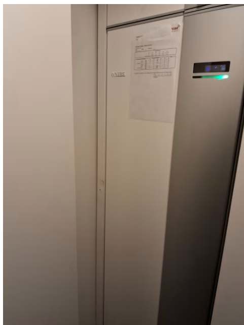
Avtrekkvarmepumpe er plassert i bod/teknisk rom.
