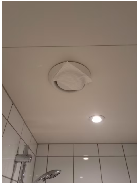
Avtrekkseffekt er testet med papir.
