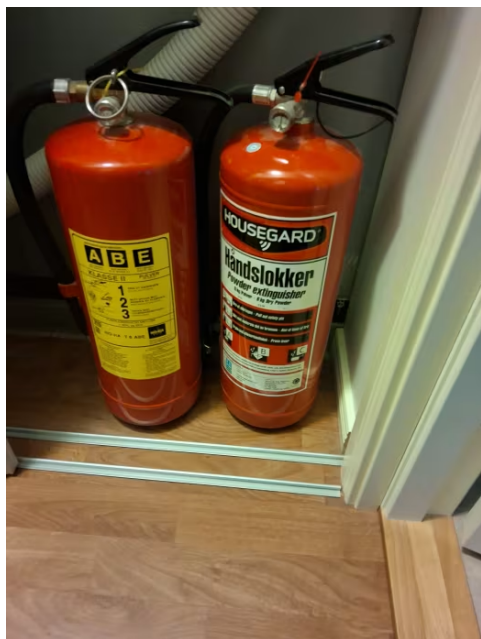
Brannslukningsapparat er plassert i bod/teknisk rom.
