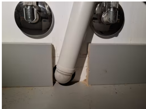
Rørgjennomføring til avløpsrør er ikke forskriftsmessig tett.
