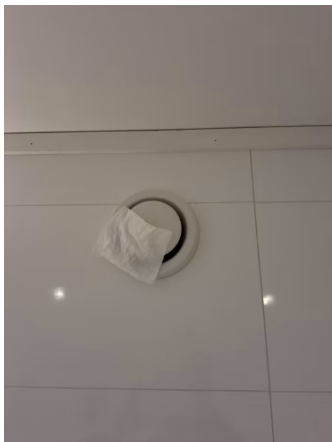
Avtrekkseffekten er testet med papir.
