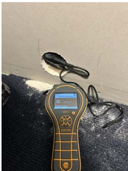
Bilde fra fuktmåling i veggkonstruksjon tilstøtende våtsone.
