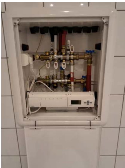
Fordelerskap for vannbåren gulvvarme med styreenhet plassert på bad.
