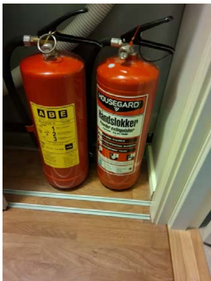
Brannslukningsapparat er plassert i bod/teknisk rom.
