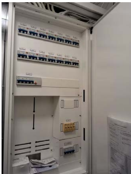
Sikringsskap med automatsikringer plassert i bod/teknisk rom.
