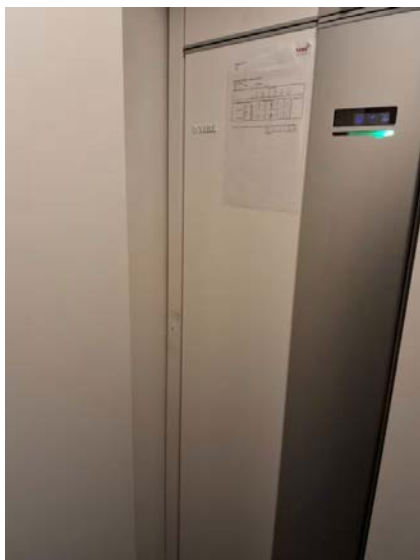
Avtrekkvarmepumpe er plassert i bod/teknisk rom.
