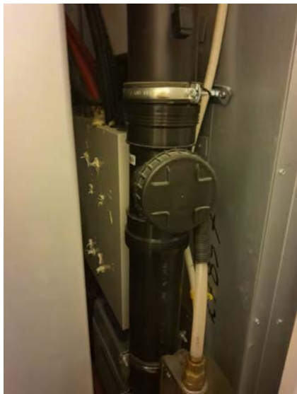
Stakeluke er plassert i bod/teknisk rom.
