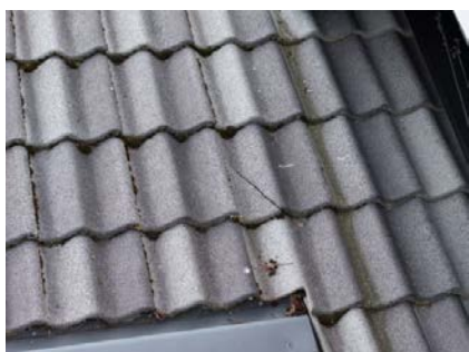
Det registreres en knekt takstein ved takvindu.
