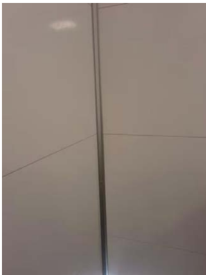
Innerhjørner er ikke tett med tilstrekkelig fugemasse (plater kan beveges fra klemlist).
