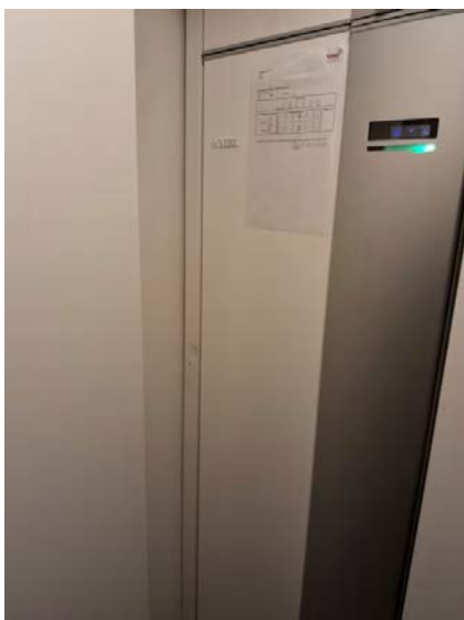
Avtrekksvarmepumpe er plassert i bod/teknisk rom.
