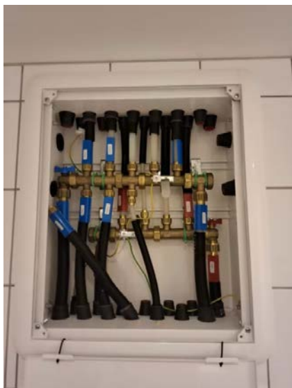
Fordelerskap for rør-i-rør med stoppekraner er plassert på bad i 2. Etasje.
