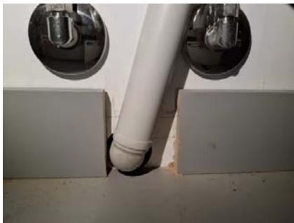
Rørgjennomføring til avløpsrør er ikke forskriftsmessig tett.
