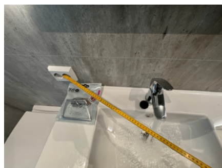
Stikkontakt montert i våt sone.
