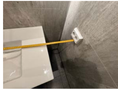
Det er plassert stikkontakt i våt sone på badet.
