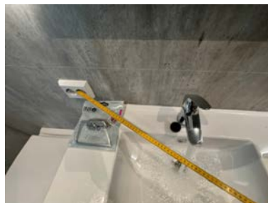
Stikkontakt montert i våt sone.
