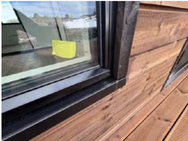
Skade på vindusglasset.
