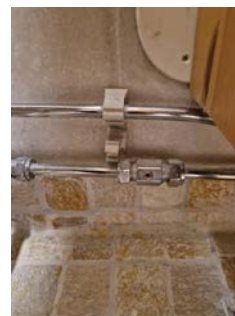
Stengeventiler , mangler vendere.
