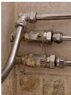
Stengeventiler , mangler vendere.
