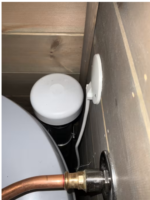
Viser lufting av avløpsanlegget med durgoventil.
