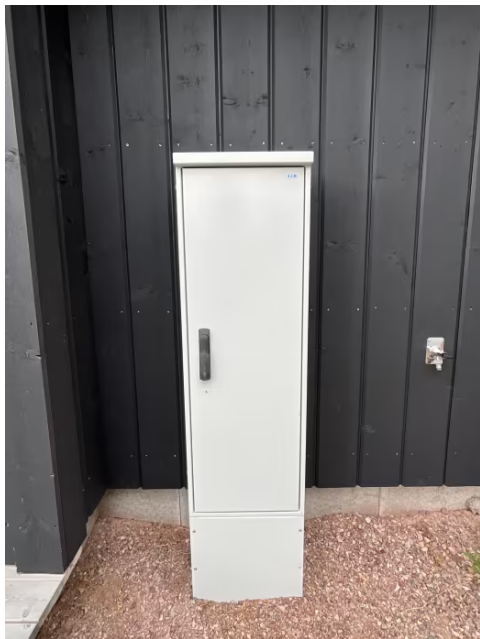
Viser inntakskap med måler.
