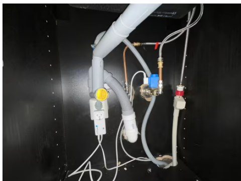
Viser vann og avløpsinstallasjoner under kum.
