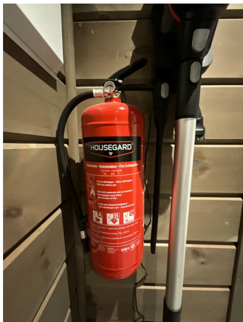
Viser vegghegt brannslukningsapparat plassert i gang.
