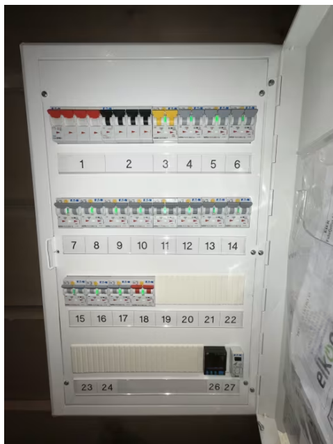
Viser innfelt sikringskapp plassert i gang. Overbelastningsvern på 4 x 40A.
