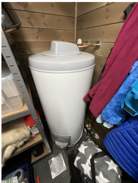
Viser bereder plassert i bod.
