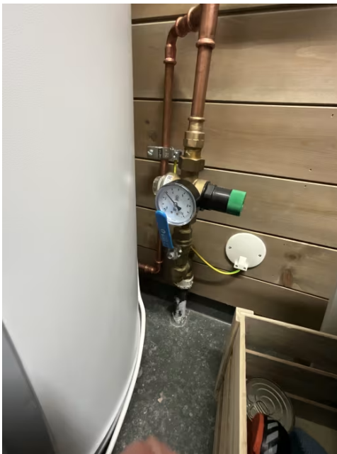
Viser vanninntak og hovedstoppekran plassert i bod.
