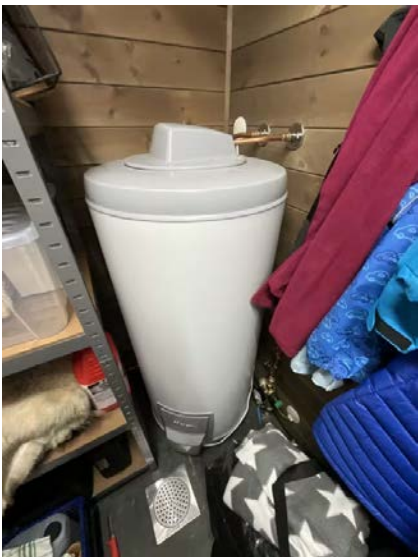
Viser bereder plassert i bod.
