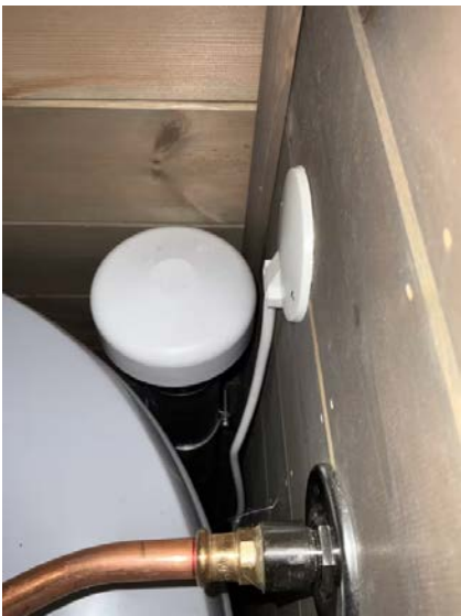
Viser lufting av avløpsanlegget med durgoventil.
