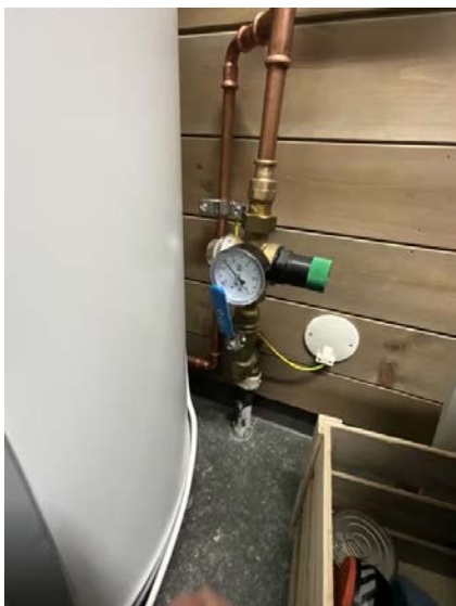
Viser vanninntak og hovedstoppekran plassert i bod.
