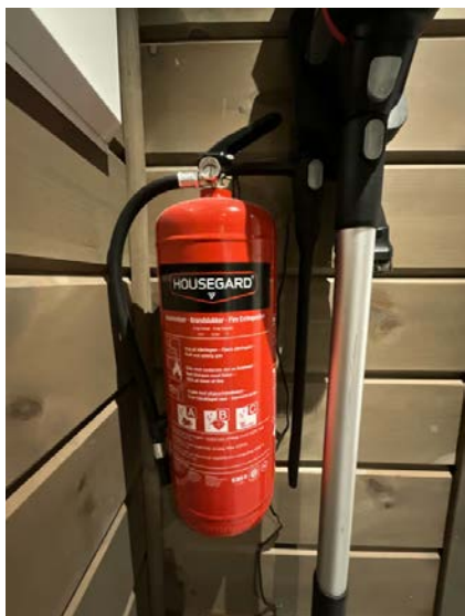
Viser vegghengt brannslukningsapparat plassert i gang.
