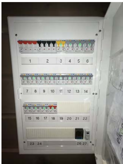
Viser innfelt sikringsskap plassert i gang. Overbelastningsvern på 4 x 40A.
