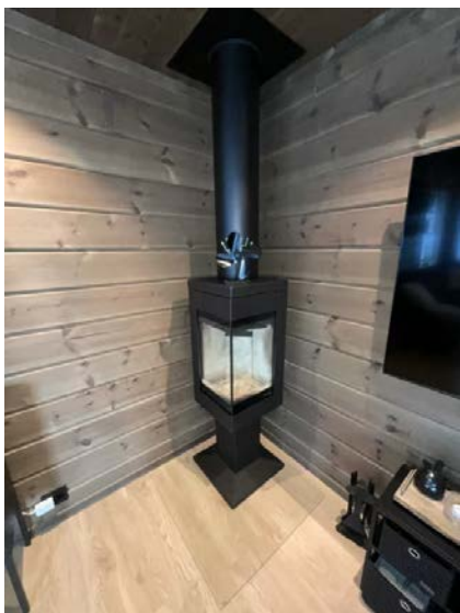
Viser ildsted plassert i stue 1.etasje.
