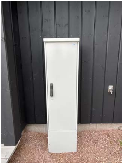
Viser inntakskap med måler.
