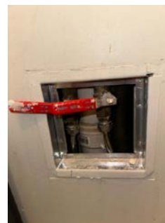
Stoppekraner plassert på kjøkken
