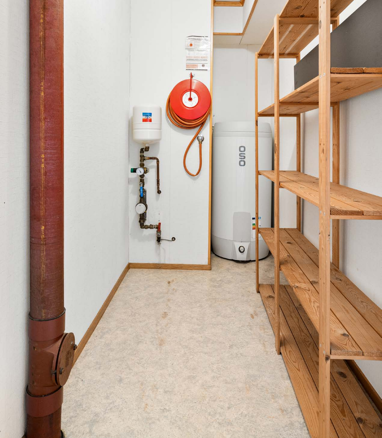
Mellom bad og kjøkken har man bod for oppbevaring og lagring, her står også varmtvannsberederen som nylig er skiftet.
