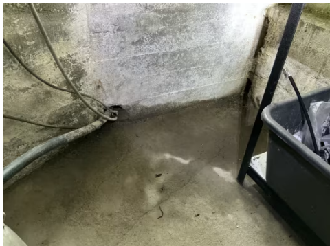
Vanninnsig/vann på gulv i kjeller.
