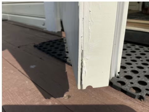
Sprekk på dørblad til inngangsdør.
