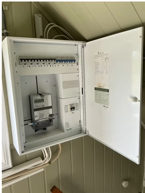
Sikringsskap står på loft.
