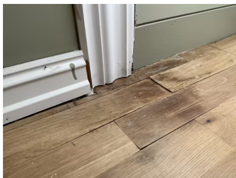
Fukt-merker på gulv.
