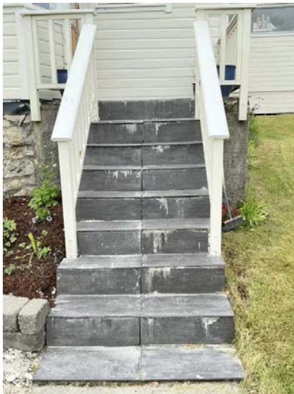
Born (hulrom under) i flere fliser. Flise er ikke fagmessig satt opp.
