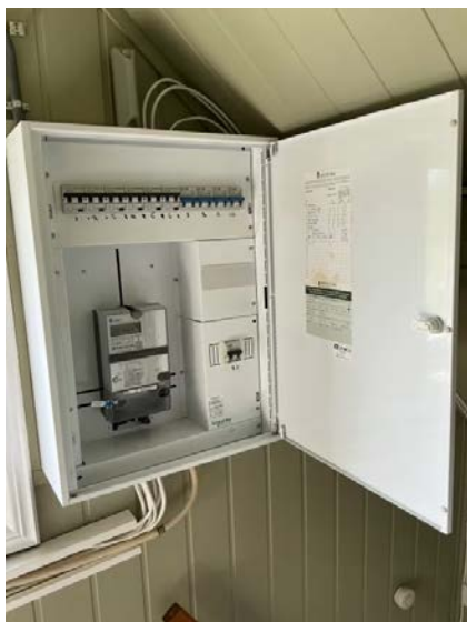
Sikringsskap står på loft.
