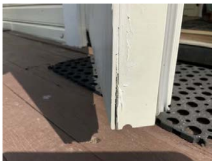
Sprekk på dørblad til inngangsdør.
