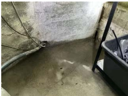
Vanninnsig/vann på gulv i kjeller.
