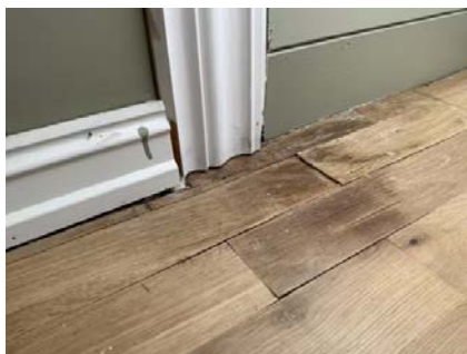
Fukt-merker på gulv.
