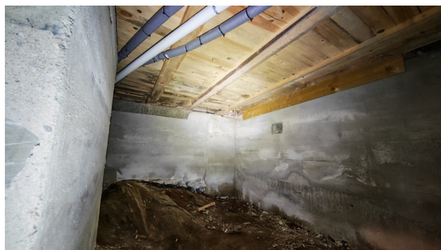
Kokonger og misfargning/skjolder i stubbeloft.
