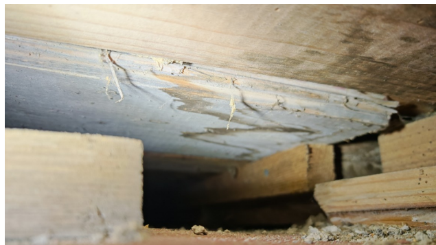
Mindre / ukjent fuktskjold
