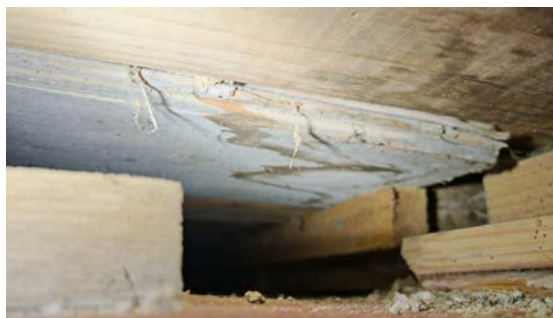
Mindre / ukjent fuktskjold
