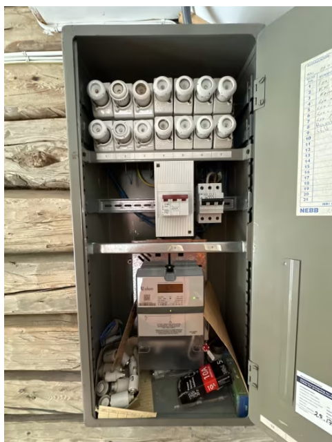
Viser sikringskap plassert i 2.etasje
