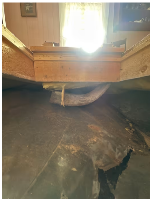
Det er synlige fuktskader og plater har løsnet. Isolasjonen er fritt eksponert.
