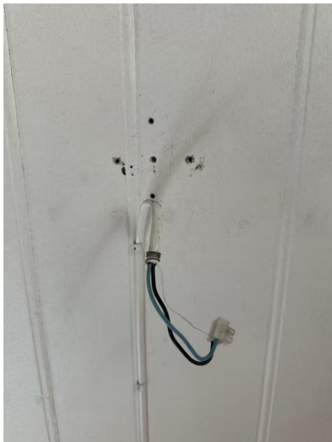
Kabel er ikke forsvarlig avsluttet.
