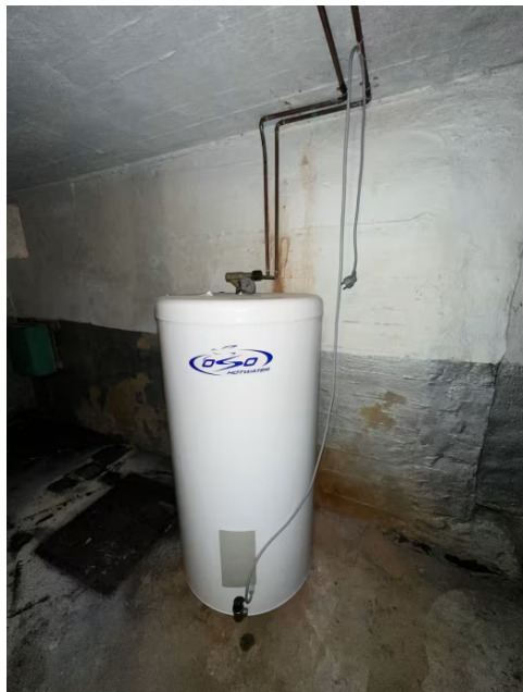
Viser varmtvannsbereder plassert i kjeller.
