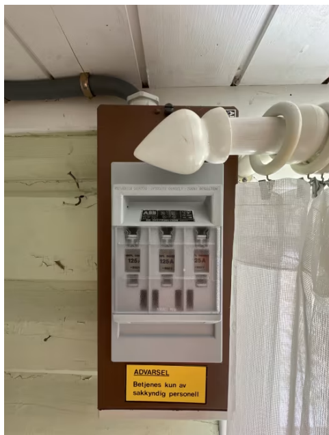
Viser inntakssikringer i 2.etasje.
