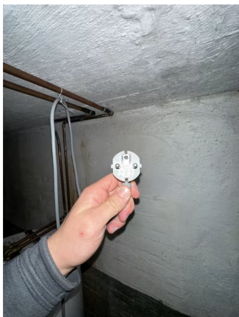
Bereder tilkoblet veggstikk. Ingen tegn til varmgang ved støpsel.
