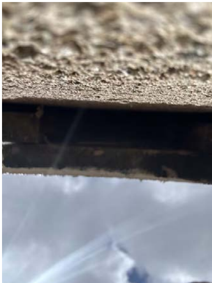
Viser lufting av kledningen og manglende musebånd.
