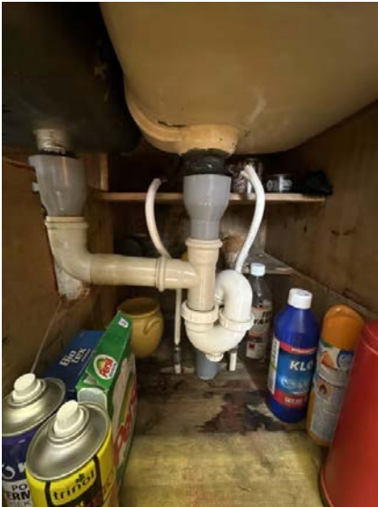
Viser vann og avløpsinstallasjoner under kum.
