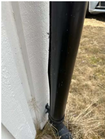
Det ble registrert buling/skade i nedløpsrør som er et symptom på frostspreng.
