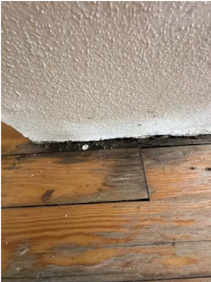
Viser råteskader ved gulv på soverom i 2.etasje
