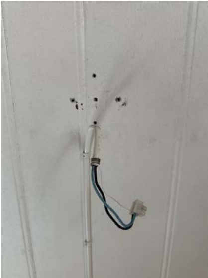
Kabel er ikke forsvarlig avsluttet.
