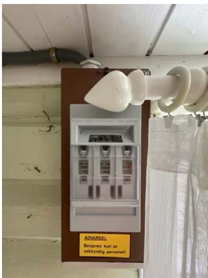
Viser inntakssikringer i 2.etasje.
