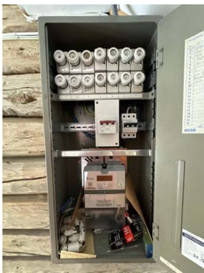
Viser sikringsskap plassert i 2.etasje
