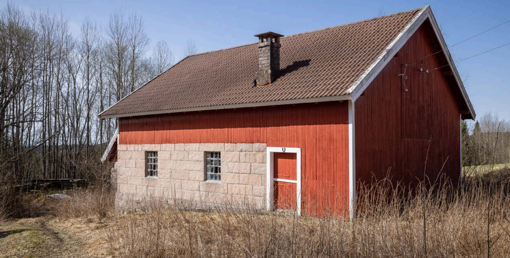
Fjøs fra ca. 1920 med gjødselkjeller og 2 etasjer. Bygningen har ikke vært i bruk siden 1950-tallet og har vedlikeholdsbehov.
