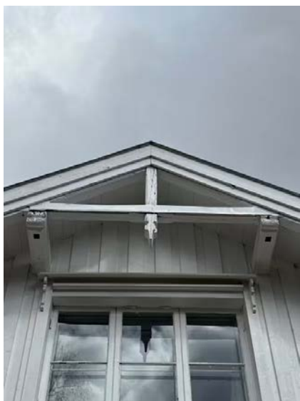
Det registreres stedvis råteskader ved mønekryss.
