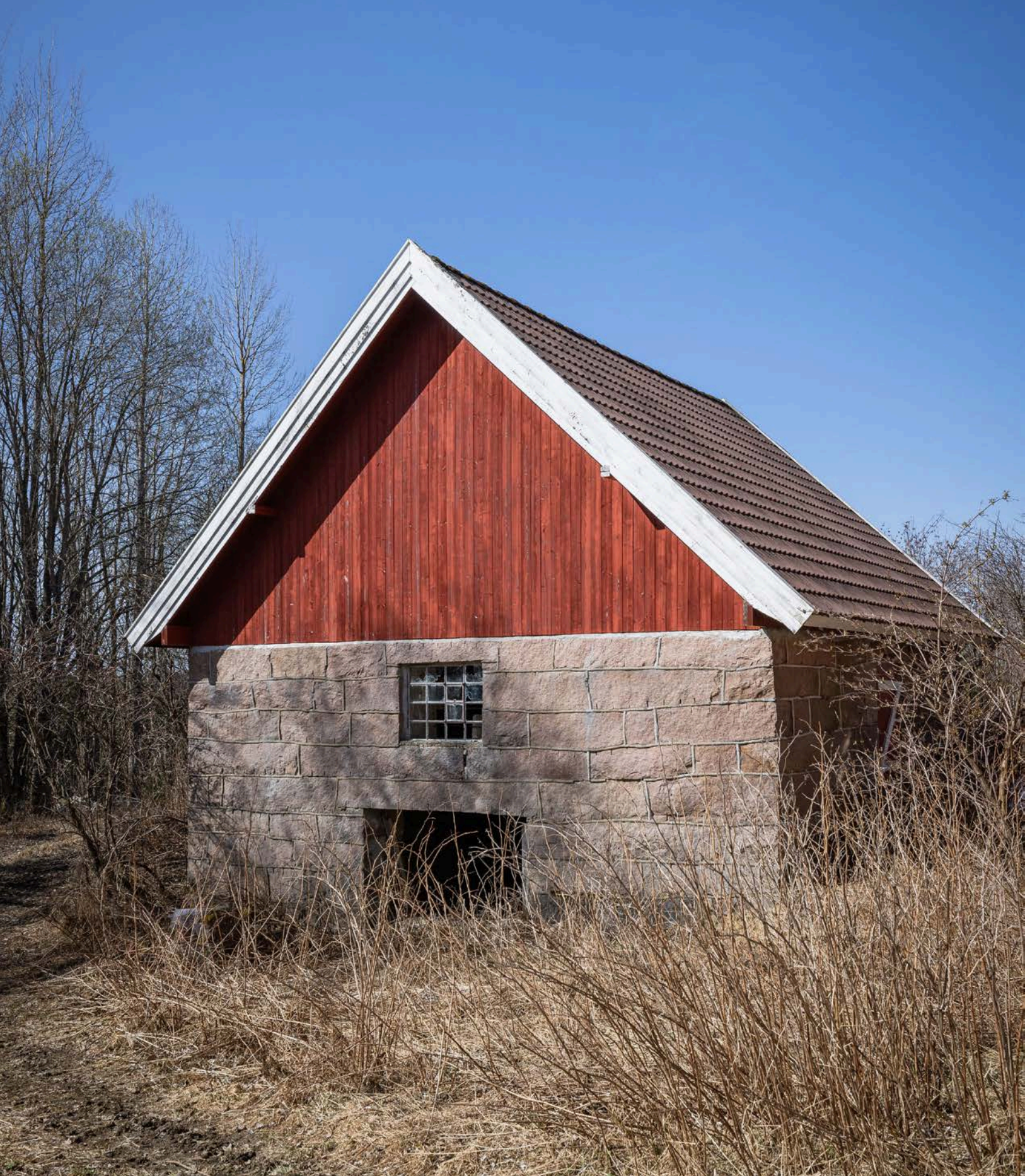
Grisehus fra ca. 1920 med gjødselkjeller og 1. etasje samt loftsrom. Bygningen har ikke vært i bruk siden 1950-tallet og har vedlikeholdsbehov.
