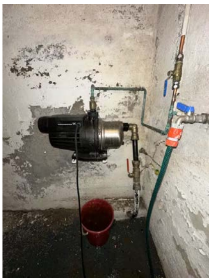
Viser vanninntak, hovedstoppekran og sirkulasjonspumpe plassert i kjeller.
