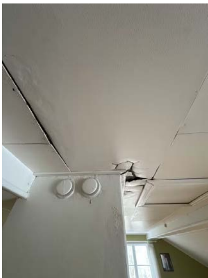
Viser skader i himling etter en tidligere taklekkasje.
