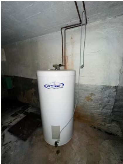
Viser varmtvannsbereder plassert i kjeller.
