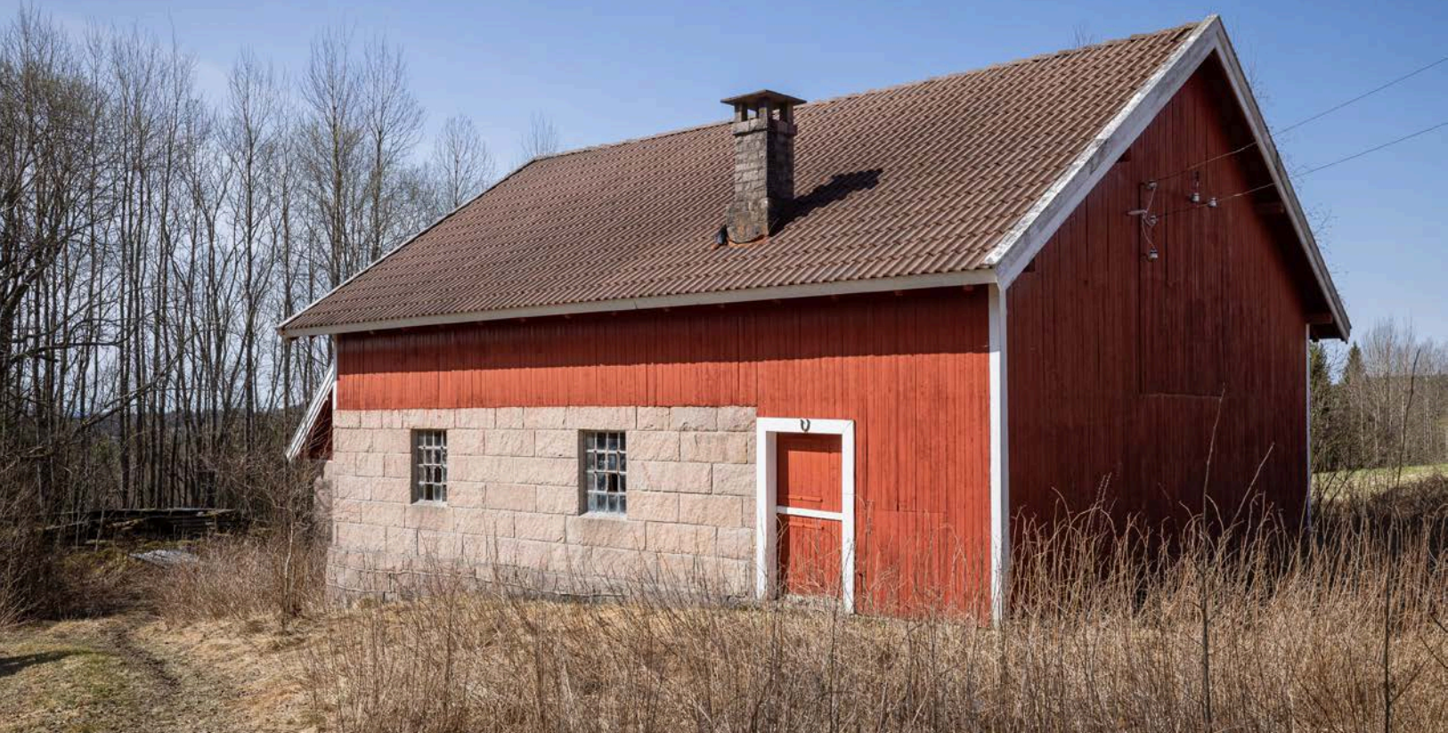
Fjøs fra ca. 1920 med gjødselkjeller og 2 etasjer. Bygningen har ikke vært i bruk siden 1950-tallet og har vedlikeholdsbehov.
