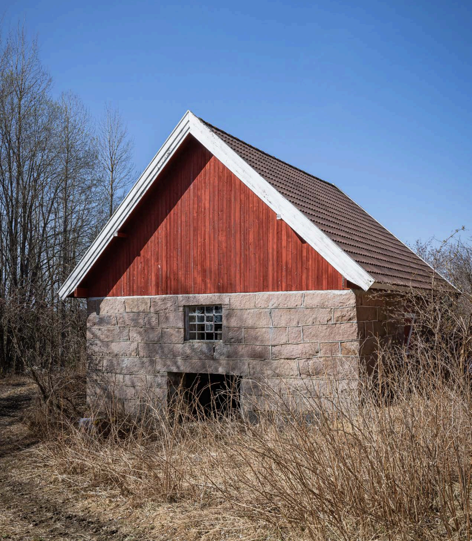
Grisehus fra ca. 1920 med gjødselkjeller og 1. etasje samt loftsrom. Bygningen har ikke vært i bruk siden 1950-tallet og har vedlikeholdsbehov.
