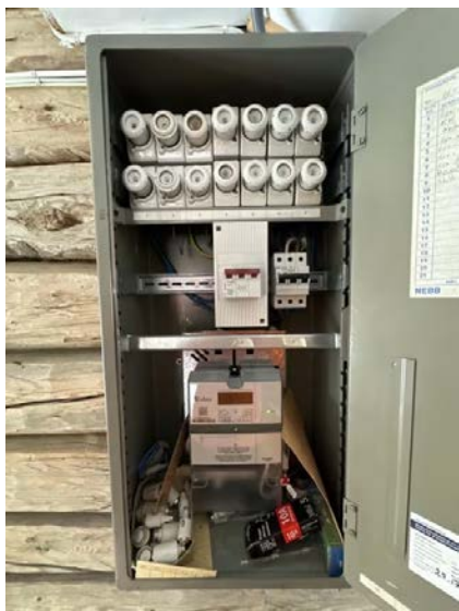
Viser sikringsskap plassert i 2.etasje
