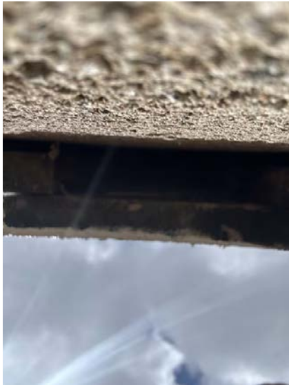
Viser lufting av kledningen og manglende musebånd.
