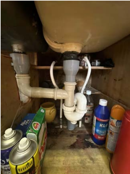
Viser vann og avløpsinstallasjoner under kum.
