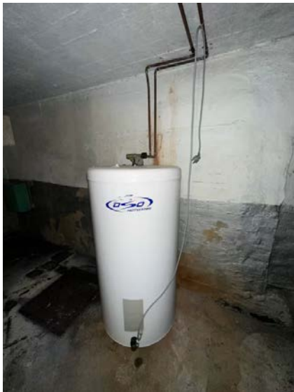
Viser varmtvannsbereder plassert i kjeller.
