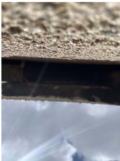
Viser lufting av kledningen og manglende musebånd.
