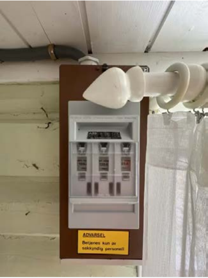
Viser inntakssikringer i 2.etasje.
