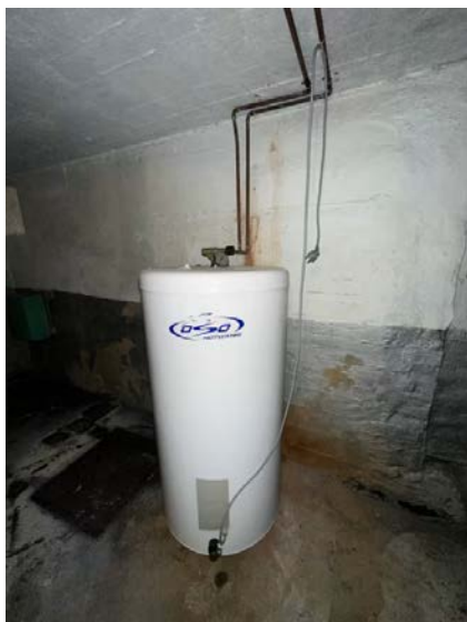
Viser varmtvannsbereder plassert i kjeller.
