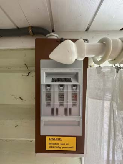
Viser inntakssikringer i 2.etasje.
