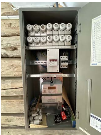
Viser sikringsskap plassert i 2.etasje
