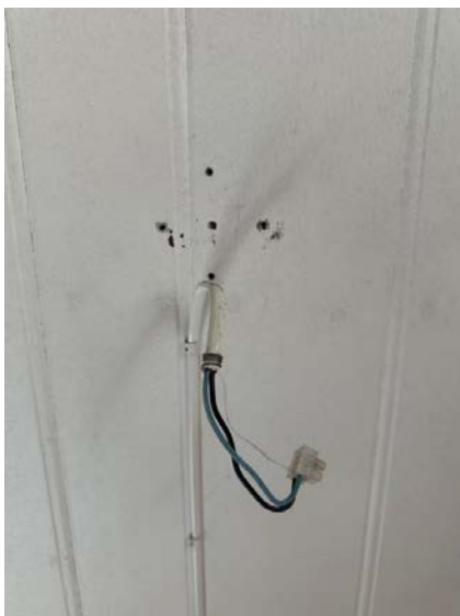
Kabel er ikke forsvarlig avsluttet.
