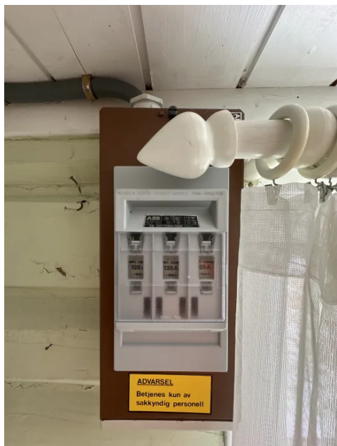
Viser inntakssikringer i 2.etasje.
