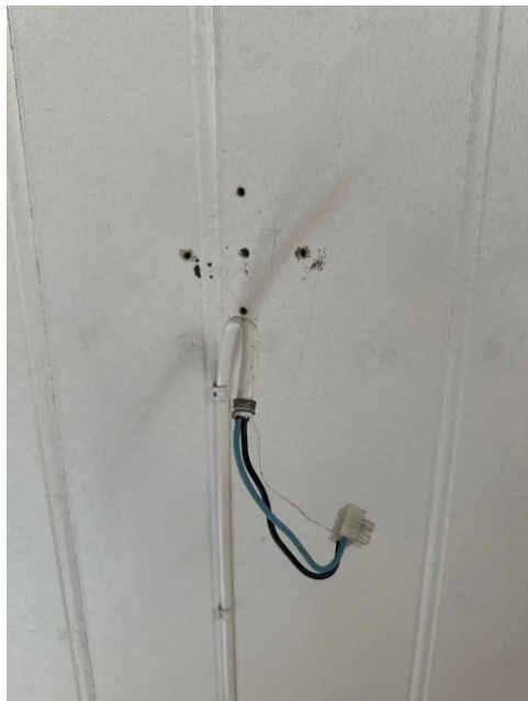
Kabel er ikke forsvarlig avsluttet.
