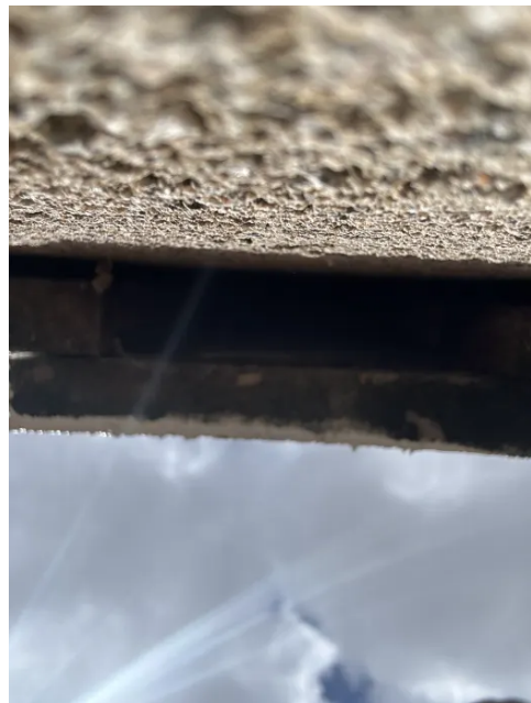
Viser lufting av kledningen og manglende musebånd.
