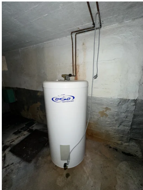
Viser varmtvannsbereder plassert i kjeller.
