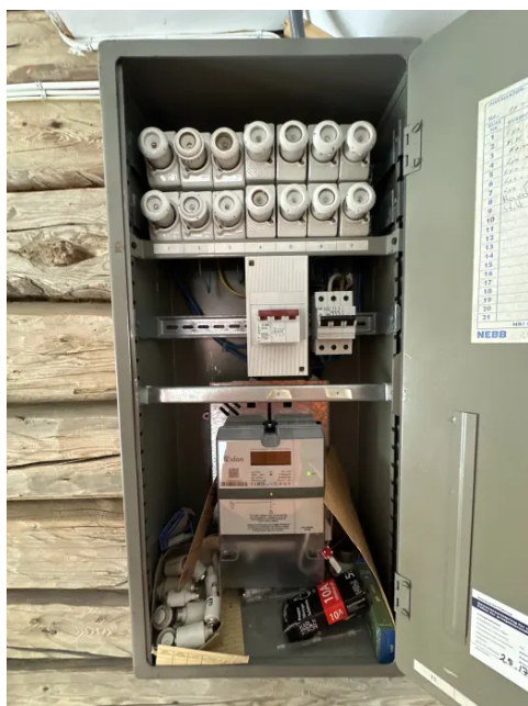
Viser sikringsskap plassert i 2.etasje
