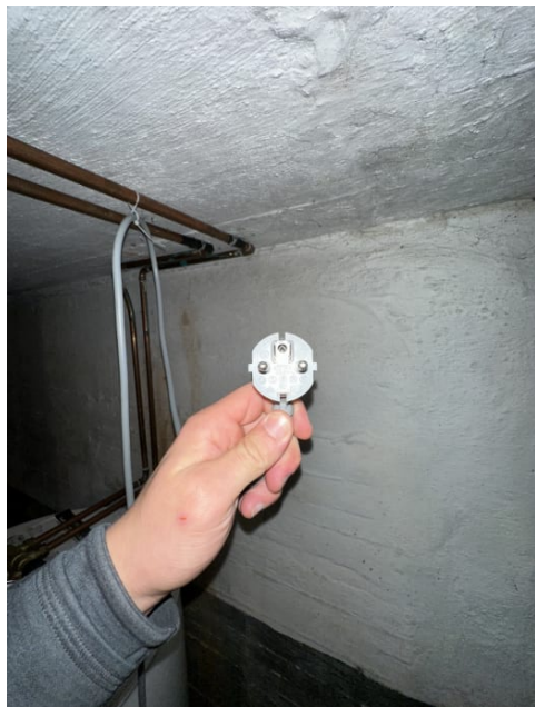
Bereider tilkoblet veggstikk. Ingen tegn til varmgang ved støpsel.
