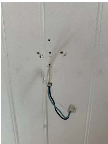
Kabel er ikke forsvarlig avsluttet.
