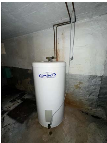
Viser varmtvannsbereder plassert i kjeller.
