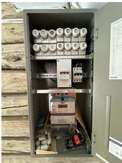
Viser sikringsskap plassert i 2.etasje
