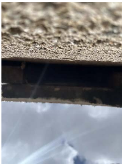
Viser lufting av kledningen og manglende musebånd.
