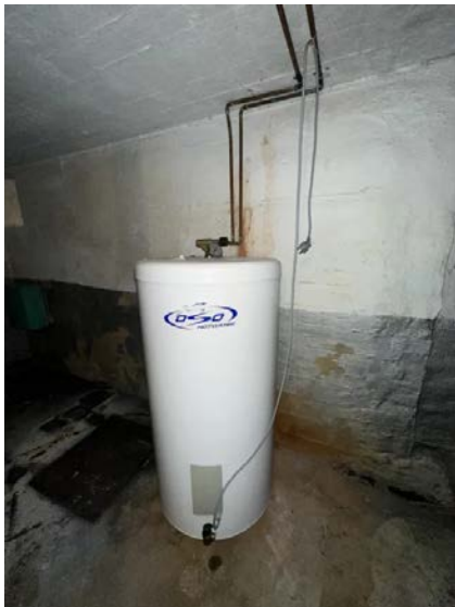
Viser varmtvannsbereder plassert i kjeller.
