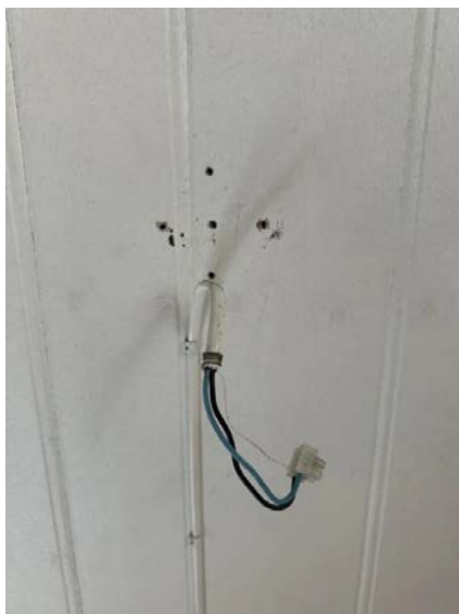
Kabel er ikke forsvarlig avsluttet.
