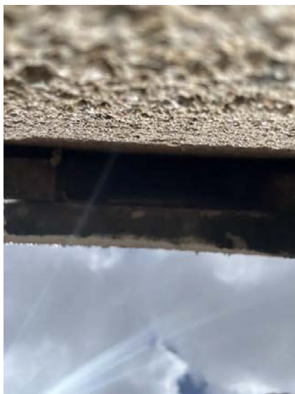
Viser lufting av kledningen og manglende musebånd.
