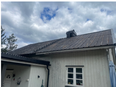
Takrenner er stedvis mangelfulle
