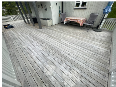
Noe værslitte terrassebord
