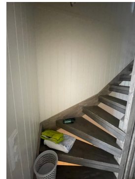
Mangler håndløper i begge trappeløp.
