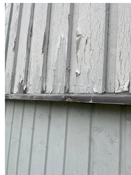
Værslitt og oppsprukket overflatebehandling.
