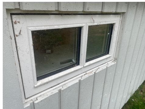
Vindu i underetasje har ufaglig løsning med manglende vannbrett/beslag, med fare for fuktvandring inn i konstruksjonen.
