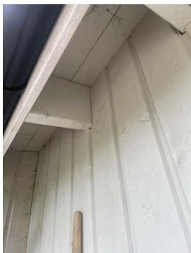
Tilbygg har mangelfull luftesjikt.
