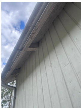
Hovedtak har mangelfull luftesjikt.
