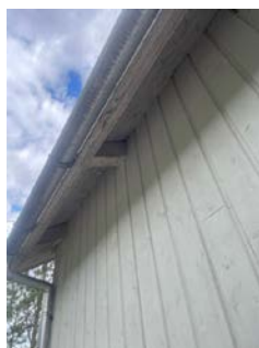
Hovedtak har mangelfull luftesjikt.
