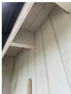
Tilbygg har mangelfull luftesjikt.
