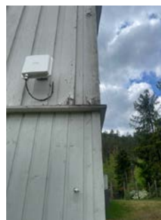
Påbegynnende råteskader i nedre del av kledningsbord.
