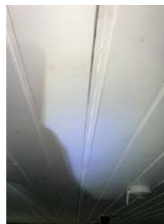
Panel har gått ut av skjøt i lengderetning
