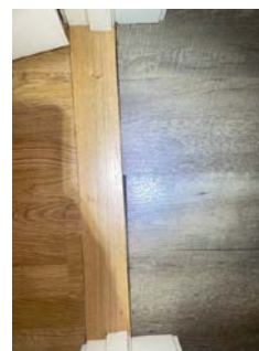
Ufaglig avslutning av gulv. Synlige ender ved terskel.
