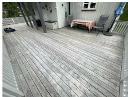
Noe værslitte terrassebord
