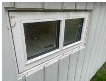
Vindu i underetasje har ufaglig løsning med manglende vannbrett/beslag, med fare for fuktvandring inn i konstruksjonen.
