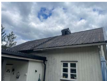
Takrenner er stedvis mangelfulle
