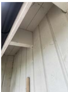
Tilbygg har mangelfull luftesjikt.
