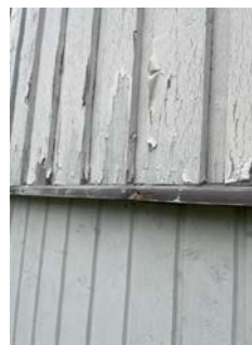
Værslitt og oppsprukket overflatebehandling.
