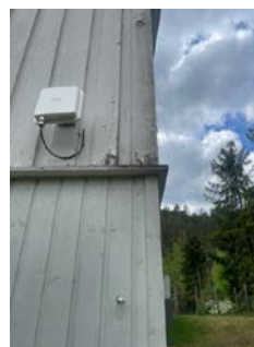
Påbegynnende råteskader i nedre del av kledningsbord.
