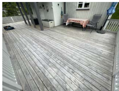
Noe værslitte terrassebord
