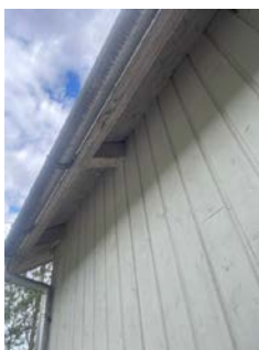
Hovedtak har mangelfull luftesjikt.
