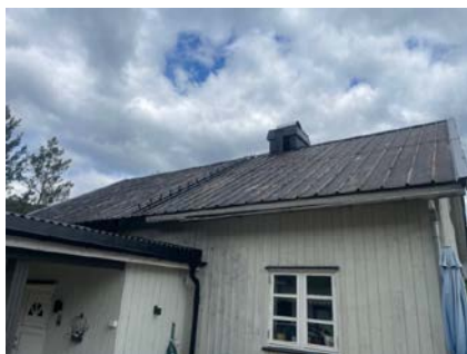
Takrenner er stedvis mangelfulle
