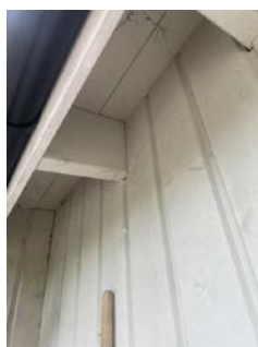
Tilbygg har mangelfull luftesjikt.
