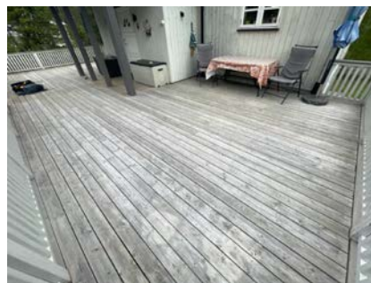
Noe værslitte terrassebord
