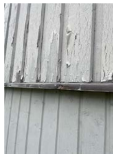
Værslitt og oppsprukket overflatebehandling.
