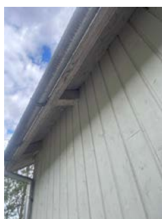
Hovedtak har mangelfull luftesjikt.
