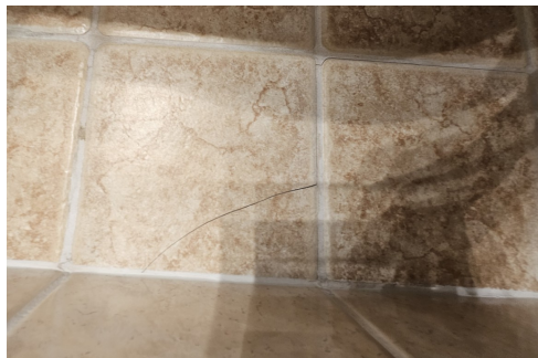
Sprekkdannelse i flis og fuger.
