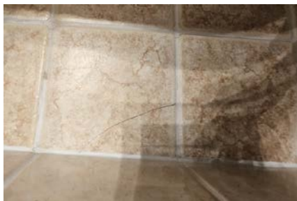
Sprekkdannelse i flis og fuger.
