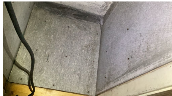
Det er observert bygningsdeler som kan være asbestholdig og krever spesialtiltak ved fjerning.
