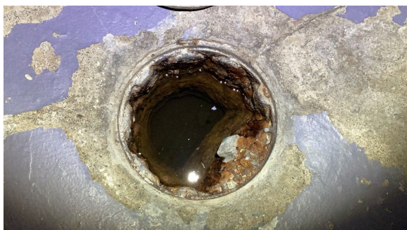
Rust observert i sluk.
