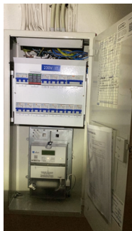
Sikringsskap lokalisert i underetasje.
