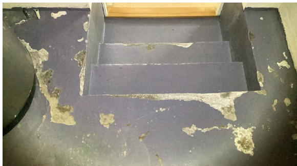
Flass på gulv i kjeller.
