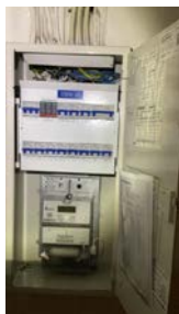
Sikringsskap lokalisert i underetasje.
