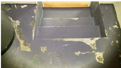
Flass på gulv i kjeller.
