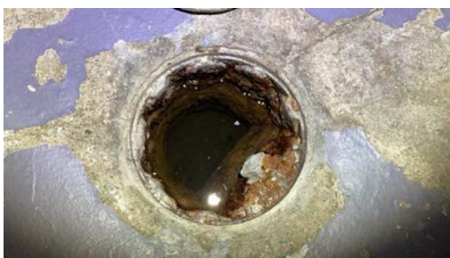
Rust observert i sluk.
