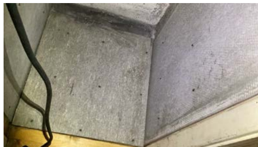
Det er observert bygningsdeler som kan være asbestholdig og krever spesialtiltak ved fjerning.
