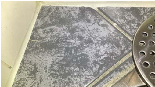
Sprekt flis i dusjsone.
