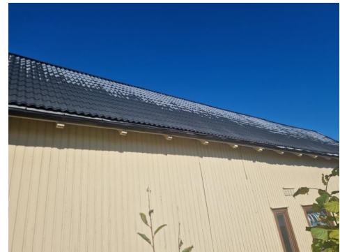
Avskaling belegg lakkert stålplater.
