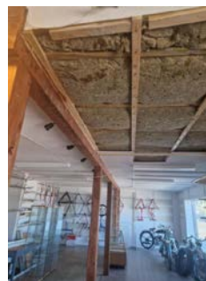
Skader etter lekkasje taktekke.
