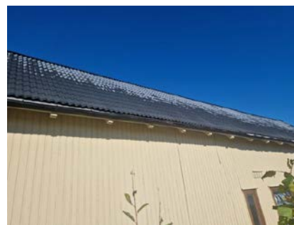
Avskaling belegg lakkert stålplater.
