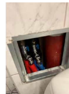
Stoppekraner plassert på bad
